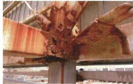
屋上看板の支柱部のサビ
