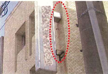
外壁との取付部の腐食
