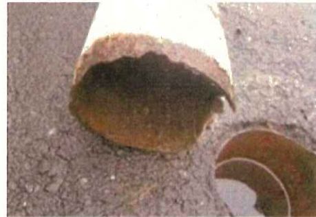
倒壊したポール看板の根本
